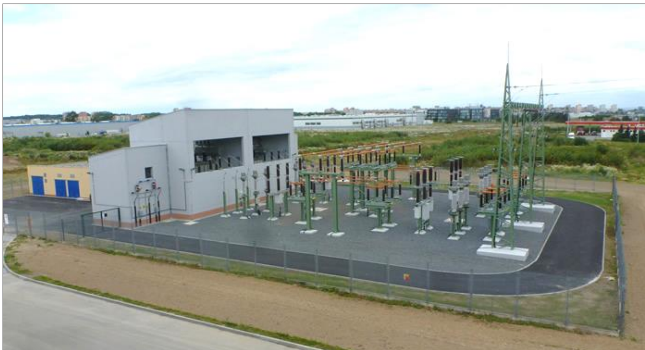
Nová rozvodna vysokého napětí v Ostravě Fifejdách, mimo jiné i pro navýšení distribuční kapacity pro přilehlou průmyslovou zónu (zdroj: www.volty.cz )
