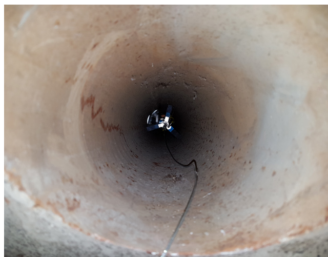
Manipulátor Horymír v ionizačním kanále reaktorové šachty
