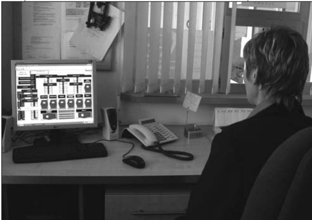
Vytápění opatovického areálu se ovládá z vrátnice počítačem
