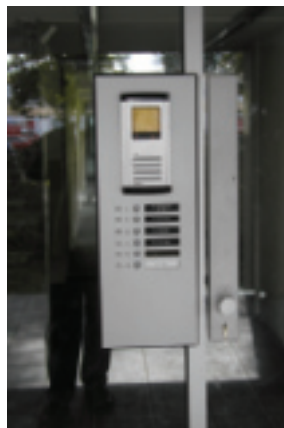
Dorozumívací zařízení u vstupu do domu
