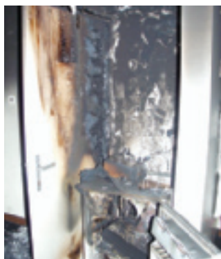
Požár bytu od závady na lednici
