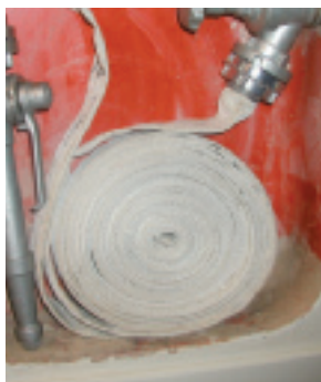
Hasicí technika v panelovém domě
