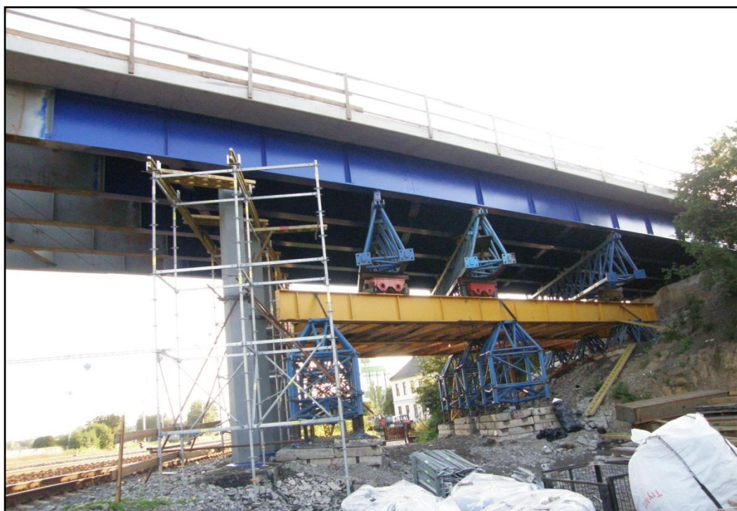
Defektně zabezpečený most, situace před zřícením.
